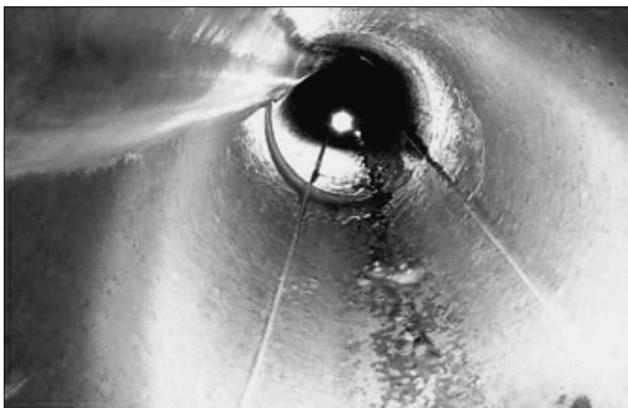
BOP v kanalizácii DN 150 mm
