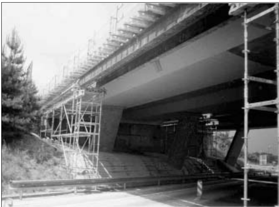
Obr. 1: Most při opravě
