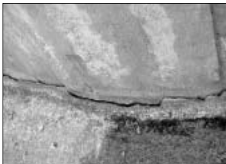
Obr. 1: Trhlina na styku dřívku a ochozu
