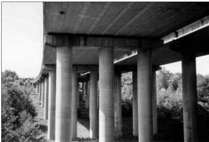
Obr. 1: Most před opravou
